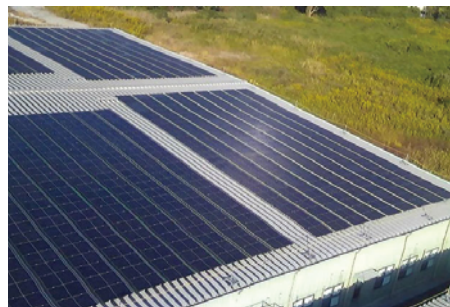
太陽光発電システム
