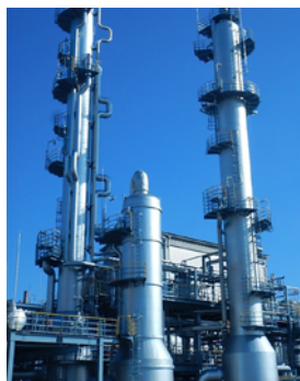
CO 2 回収設備
