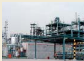
アニリン生産設備
