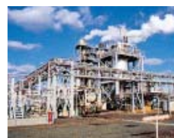
塩素リサイクル設備
