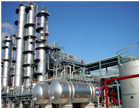
【VCM製造設備】
