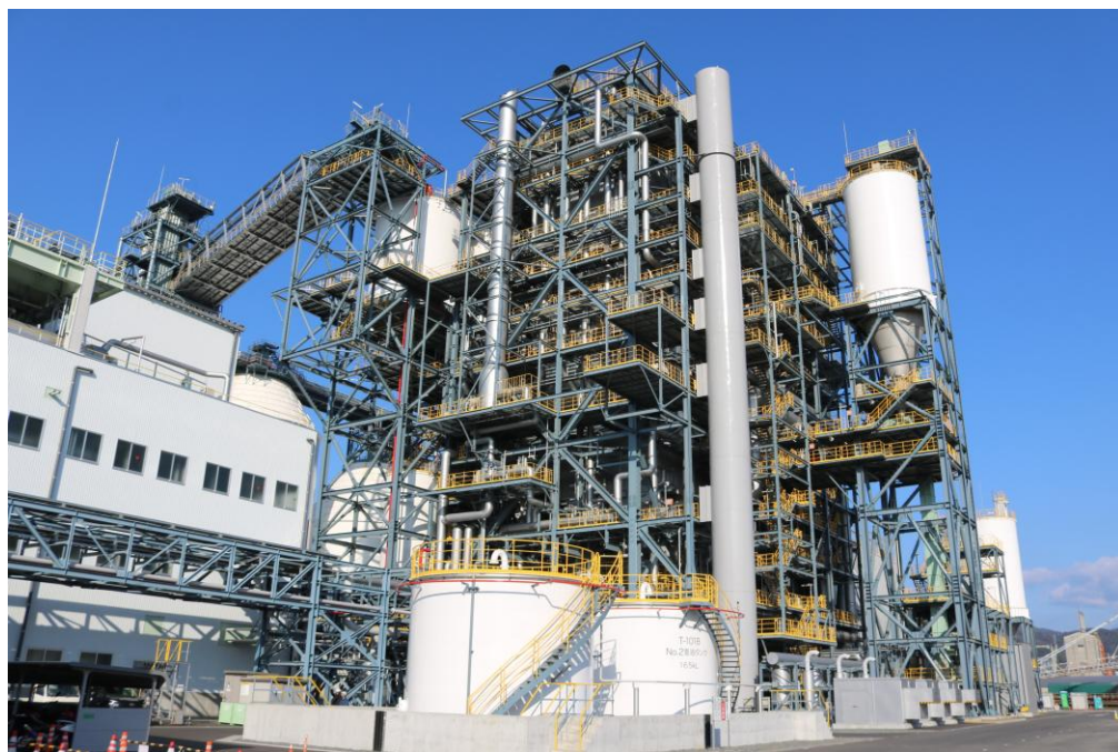
バイオマスボイラ(全景)
