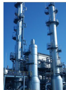
CO 2 回収および原料化設備
