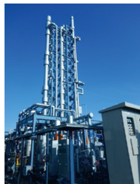
CO 2 回収アミンベンチ設備
