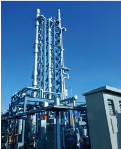
CO 2 回収実証試験設備
