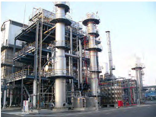
イソシアネート原料生産設備（COプラント）
