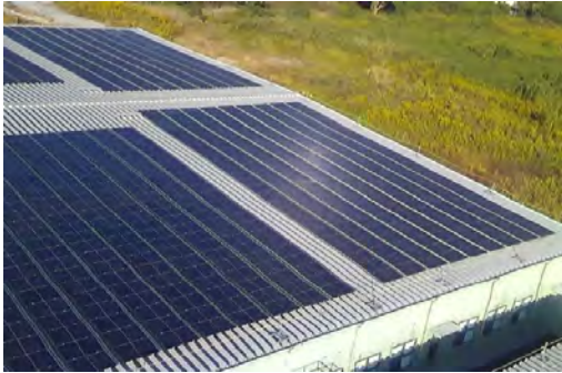
太陽光発電システム
