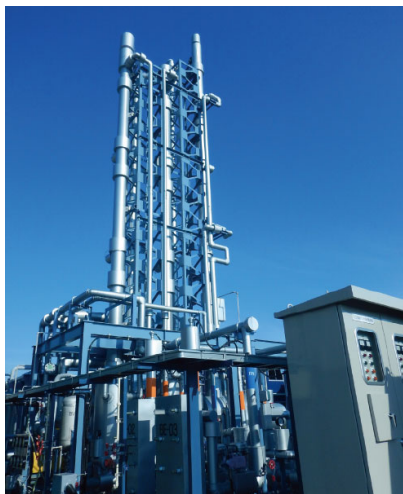
CO 2 回収実証試験設備
