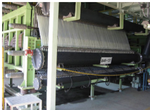
苛性ソーダの新型電解槽
