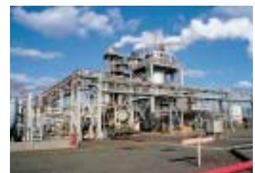
臭素リサイクル設備
