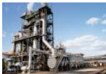
塩素リサイクル設備
